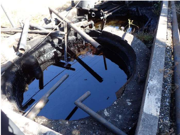
図10 C3号ろ過池
